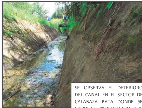
SE OBSERVA EL DETERIORO DEL PISO Y PAREDES LATERALES DEL CANAL EN EL SECTOR DE CCONCHOPATA.
