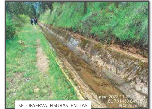
SE OBSERVA FISURAS EN LAS PAREDES LATERALES Y PISO DEL CANAL.
