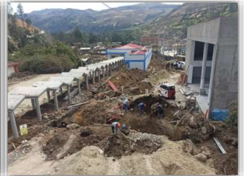
Canalizaciones, ductos y tuberías
